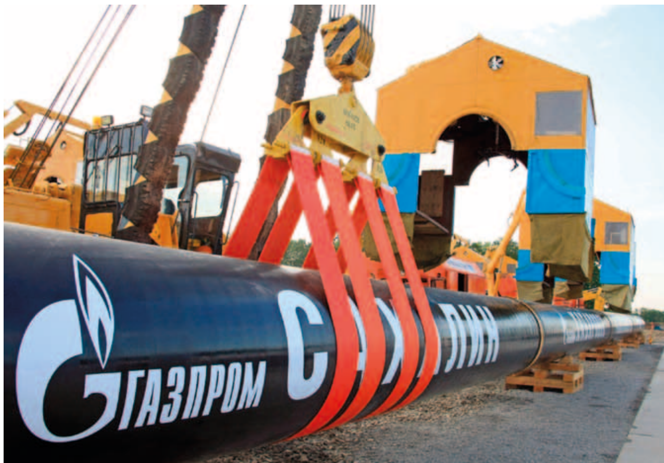
Газопровод Сахалин — Хабаровск — Владивосток (ООО «Газпром трансгаз Томск»)
